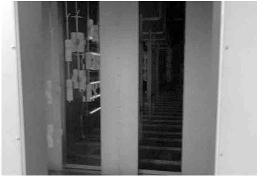
写真-11 中赤外線とガスバーナーによるハイブリッド焼き付け炉
