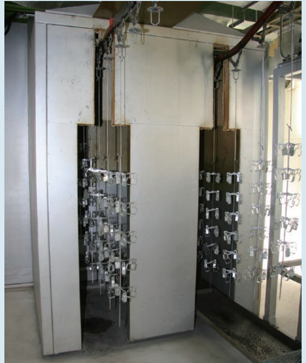
▲硬化炉の廃熱を熱源にしている水切り乾燥炉
